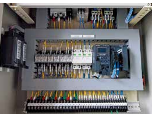
高齢農家もタッチパネルで直感的に扱える配慮をしたヒートポンプシステムの自社開発制御盤。
