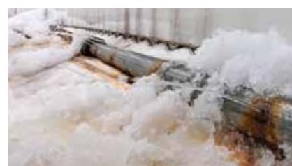
自社のハウス内に設置されたヒートポンプ。実際に稼働して、視察者へのデモンストレーションもしている。(写真上) システムのほとんどを内製できるノウハウと実績があるのが強みと語る細井友亨社長。(写真中) ヒートポンプに使った地下水はそのまま消費用にも使える。(写真下)
