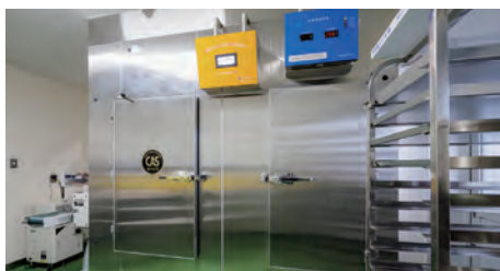
CAS冷凍を用いて、より新鮮な状態で保存をしている。
