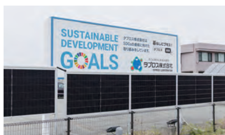
本社敷地内に設置された垂直型の太陽光パネル。ここで発電した電気は、事務所で活用している。
