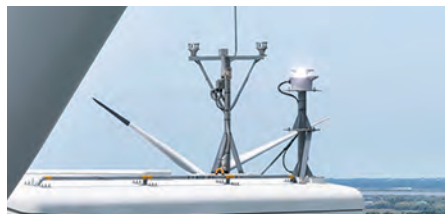
共同開発された航空障害灯は県内の風力発電機に設置されている。
