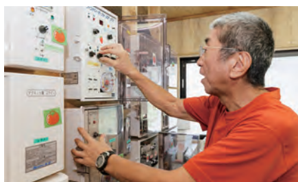
ハウス内の温度や湿度の調整を行うための装置。 事務所内に設置されており、操作性が高い。
