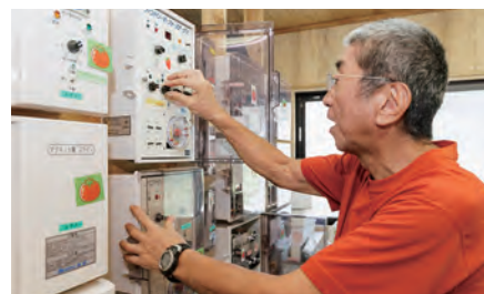
ハウス内の温度や湿度の調整を行うための装置。 事務所に設置されており、操作性が高い。
